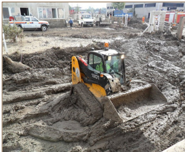
Foto 2.3.5 – Benevento: Rimozione dell'ingente quantitativo di detriti nella zona industriale, dopo il passaggio
